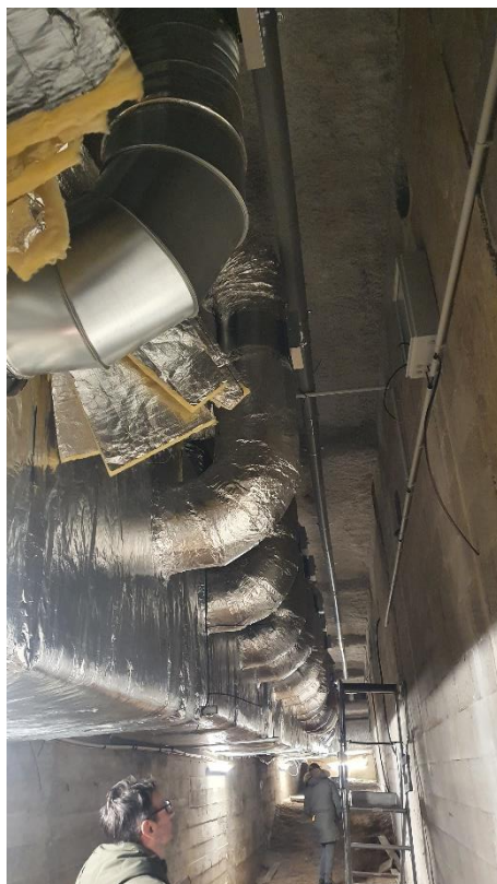
Figure 20. Nouvelles Centrale de traitement de l'air et gaines sous le bassin
