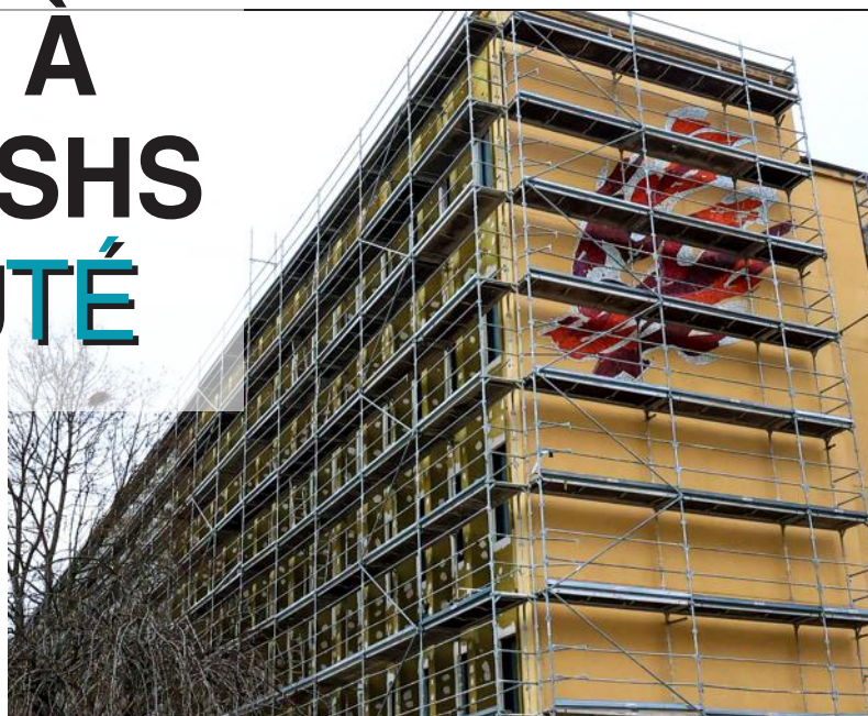
Le bâtiment des Sciences humaines et sociales, sur le campus du Saulcy, à Metz, devait être remis aux normes. PHOTO RL/KARIM SIARI
